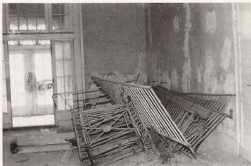
Lo stato di abbandono della palazzina, prima dei lavori.
