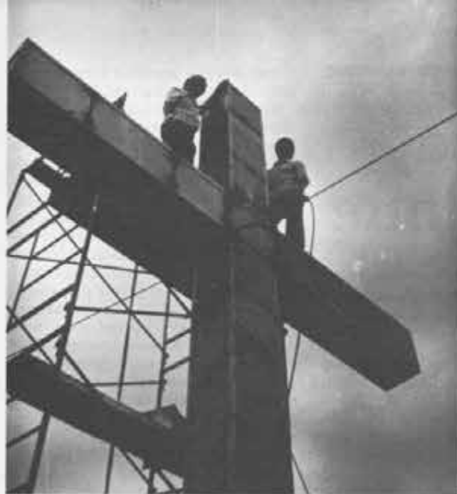
Ci sono voluti potenti carrucole, cavi robusti, e i calcoli di un ingegnere, per issare la croce e darle stabilità anche contro i venti dell'inverno.
