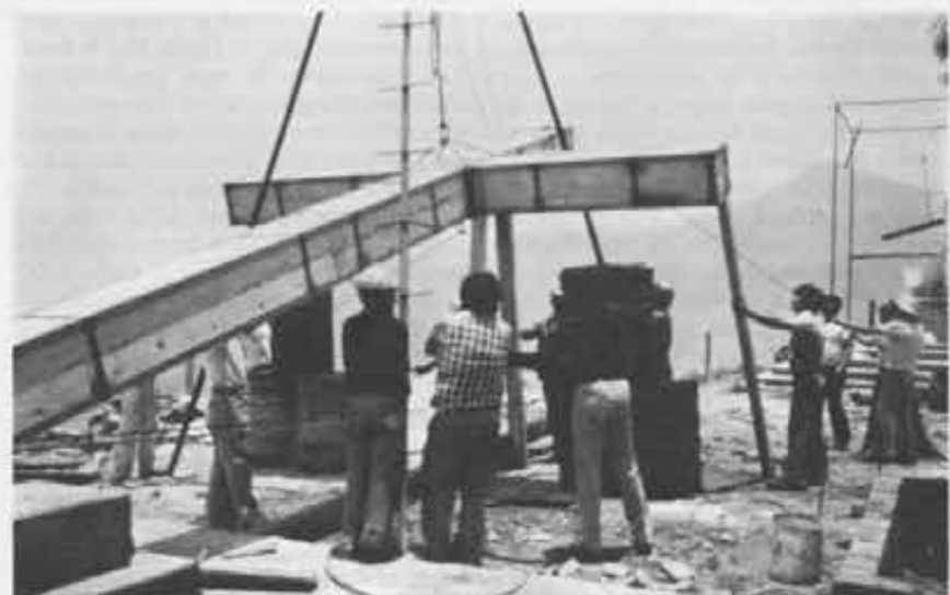
L'hanno chiamata "operazione formica": in più di 300, un giorno si presero sulle spalle i mattoni, la calce, la sabbia, la ghiaia, e in fila come tante formiche portarono tutto su in cima alla collina.
