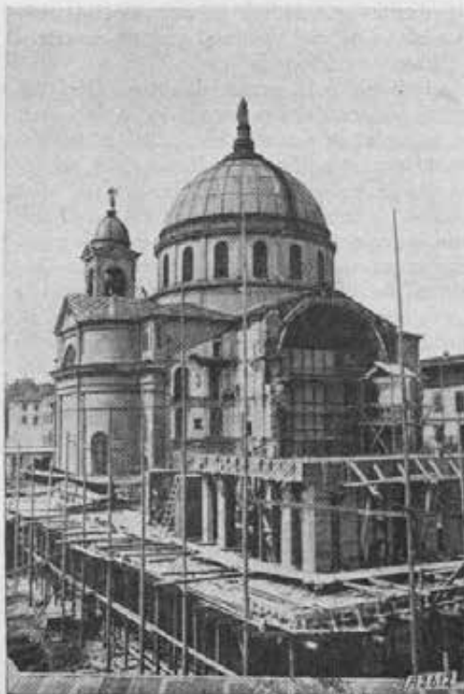
Torino. Prospetto dei lavori di ampliamento del santuario di Maria Ausiliatrice nel mese di giugno.
