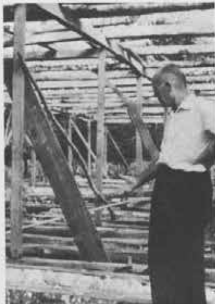
Il tetto aspetta ancora le lastre d'alluminio, non potendo reggere le pentole...
