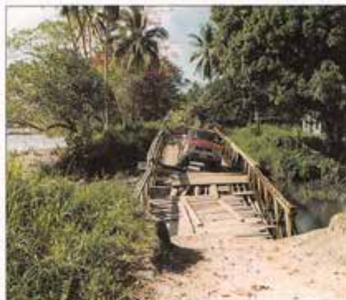
Un ponte tra i migliori che ci sono per raggiungere alcuni villaggi della parrocchia di Tetero.
