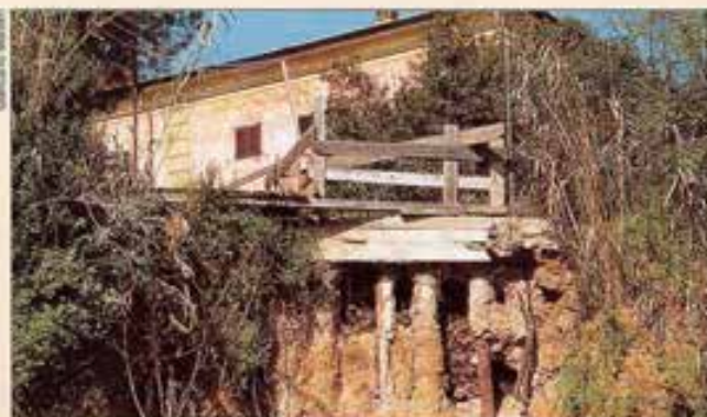
La disastrosa frana sul vicolo delle Sette Chiese, che ha bloccato lo scavo.
